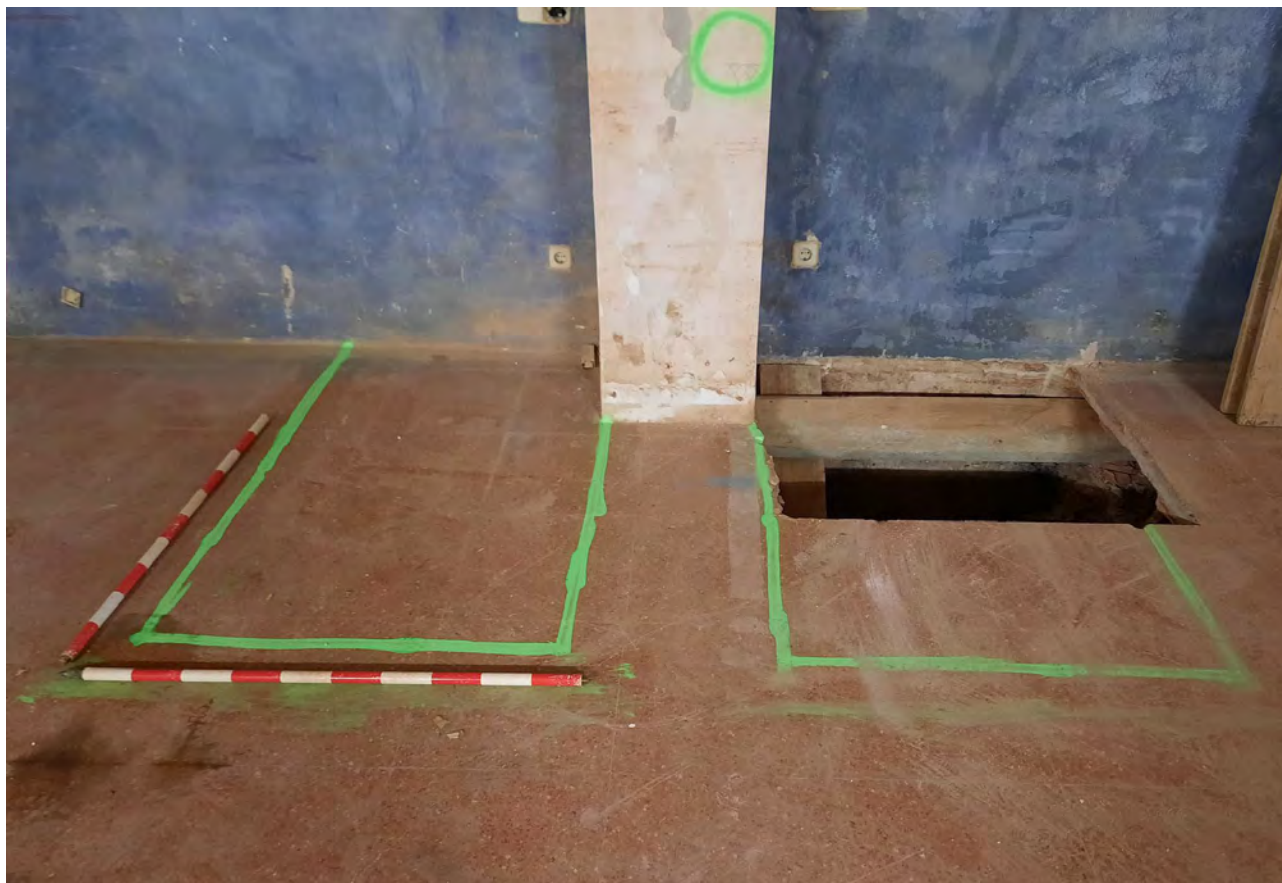
Imatge de l'estat inicial dels sondejos 5 i 7 situats al Sector Interior Colom Dret, on es pot veure el paviment UE-100 format per rajoles de terratzo. En aquesta imatge queda constància que una part del sondeig 5 va ser realitzada de forma anterior a la nostra arribada al jaciment. 28/GEN/2021 (E. Píriz).
