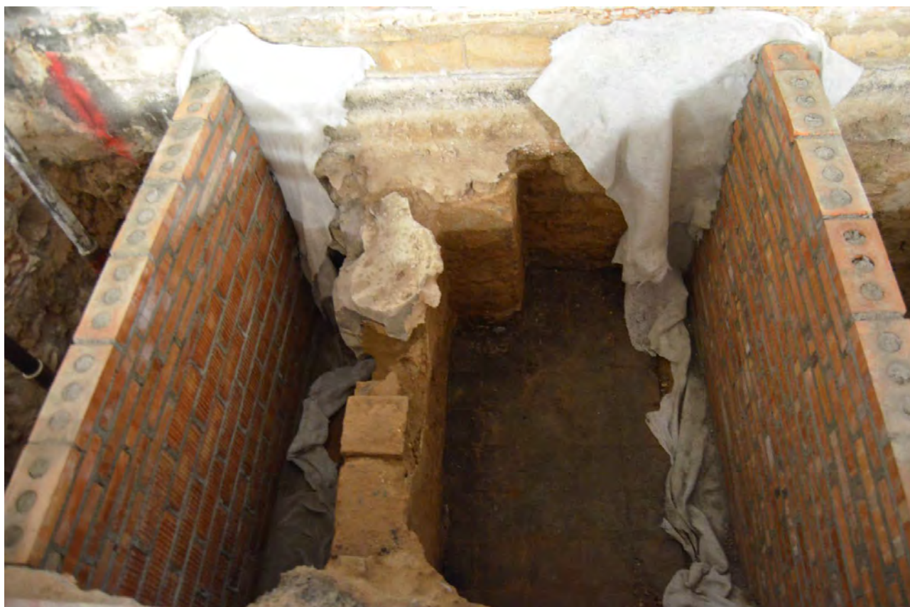
Detall de la protecció de les estructures localitzades al Sector Interior Colom Dret, amb els murs de protecció del formigonat construïts. 22/FEB/2021 (T. Rigo).
