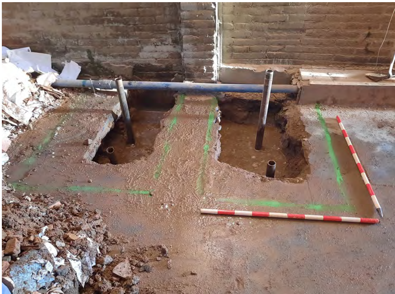
Fotografia dels sondejos I i K amb l'encepat excavat, els micropilons clavats i el morter de ciment de les injeccions reblint l'excavació dels enceps. 28/GEN/2021 (E. Píriz).
