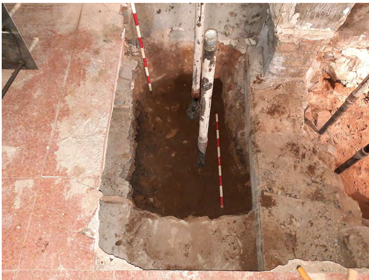
Imatge de l'estat final del sondeig 11 un cop retirat el morter de ciment Portland escampat durant la injecció dels micropilons. 15/FEB/2021 (E. Píriz).
