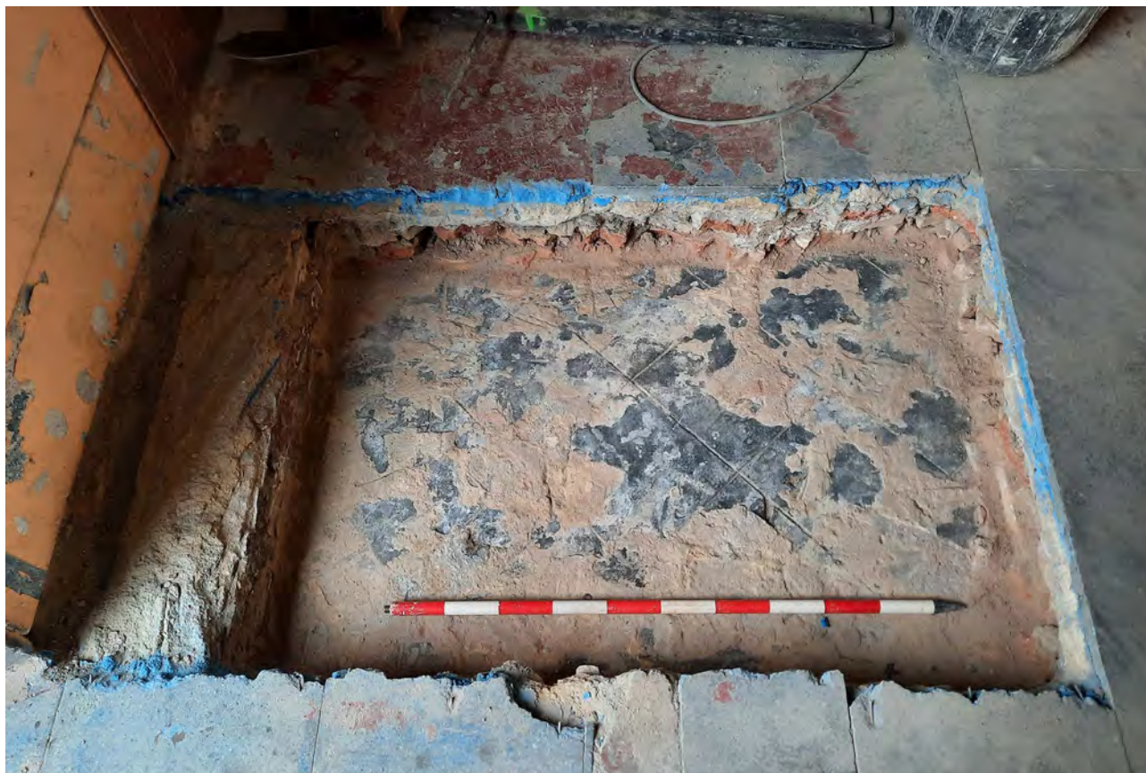
Detall del sondeig A, on es pot veure el paviment de morter de ciment Portland UE-102. També es veu la fonamentació UE-15 de la façana del passeig Colom UE-10. 12/FEB/2021 (E. Píriz).
