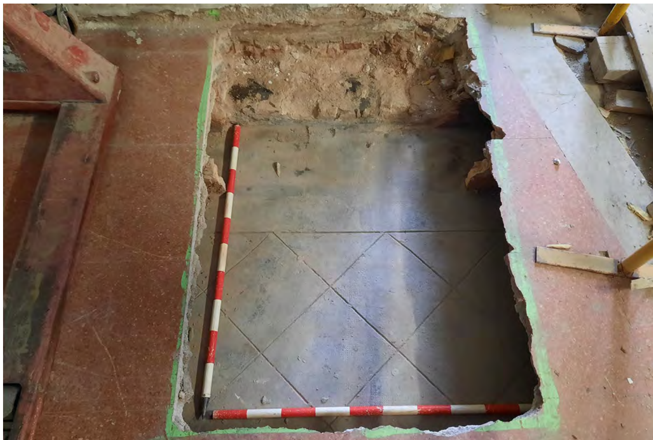
Detall del sondeig 2, on es pot veure el paviment UE-100, l'estructura d'envanets de sostremort UE-101 i el paviment de morter de ciment Portland UE-102. També es veu l'estructura UE-15 fonament de la façana. 8/FEB/2021 (E. Píriz).
