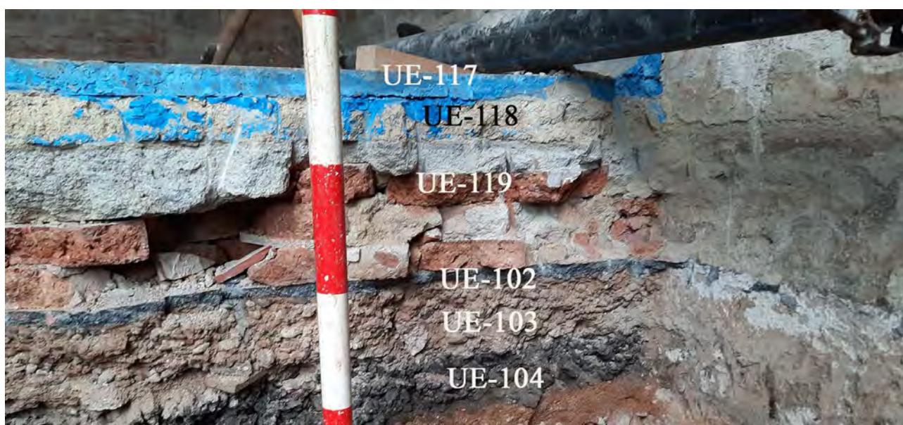
Detall del paviment UE-117, de la seva base UE-118 i de l'anivellament UE-119. Es pot veure com recolzen sobre el paviment de morter UE-102. 9/FEB/2021 (E. Píriz).
